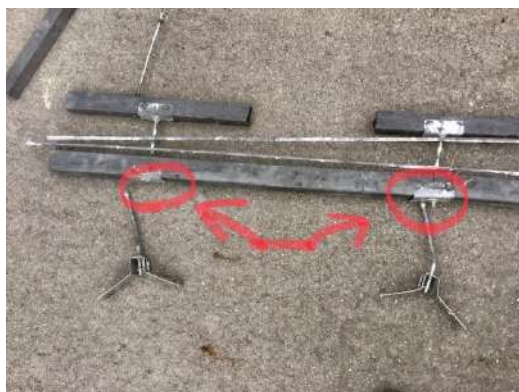
第一架台強力棟二段仕様 破損発生につき、欠損部の写真
